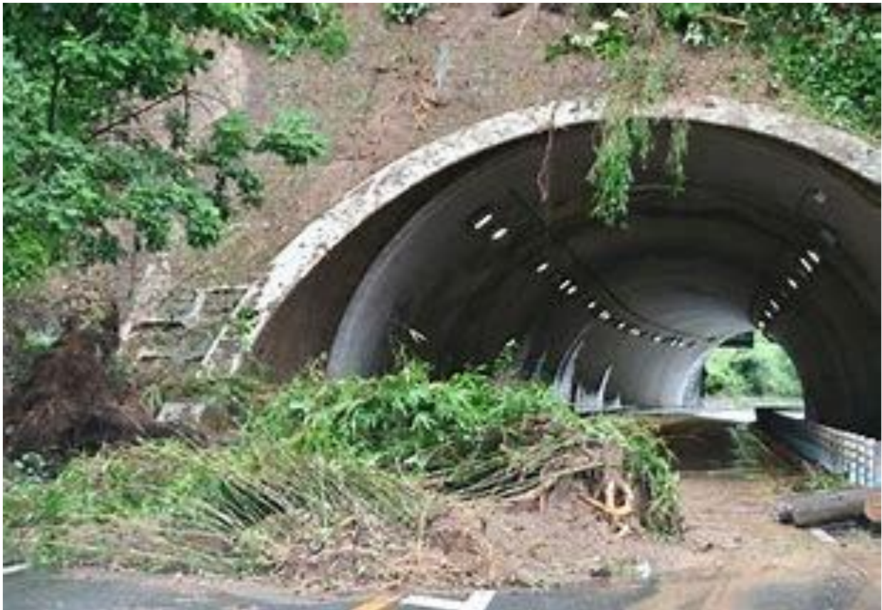
<新善波トンネル土砂崩れ>
